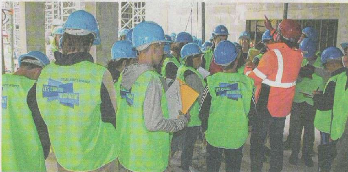
Une visite guidée du chantier, pour découvrir de manière originale les différents métiers du bâtiment.
