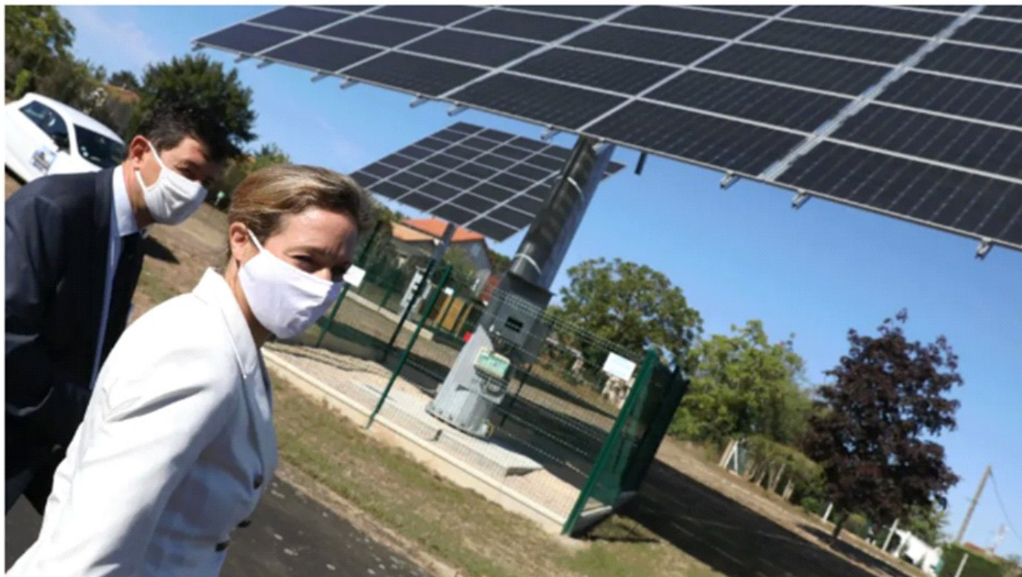
La rectrice et le proviseur devant les panneaux photovoltaïques du lycée Le Dolmen qui fournissent à eux deux 33 kWh.
